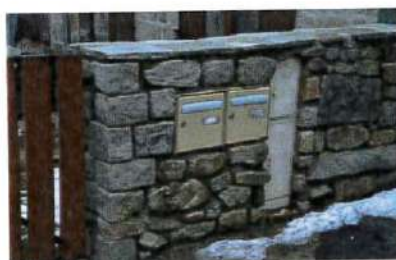
Exemple d'intégration d'éléments techniques
