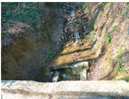
Bac de rétention Bassin la Vallière
